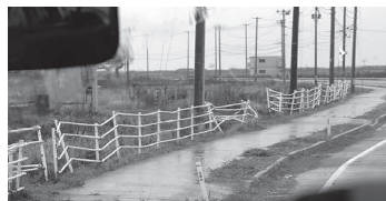
津波で損傷したガードレール
